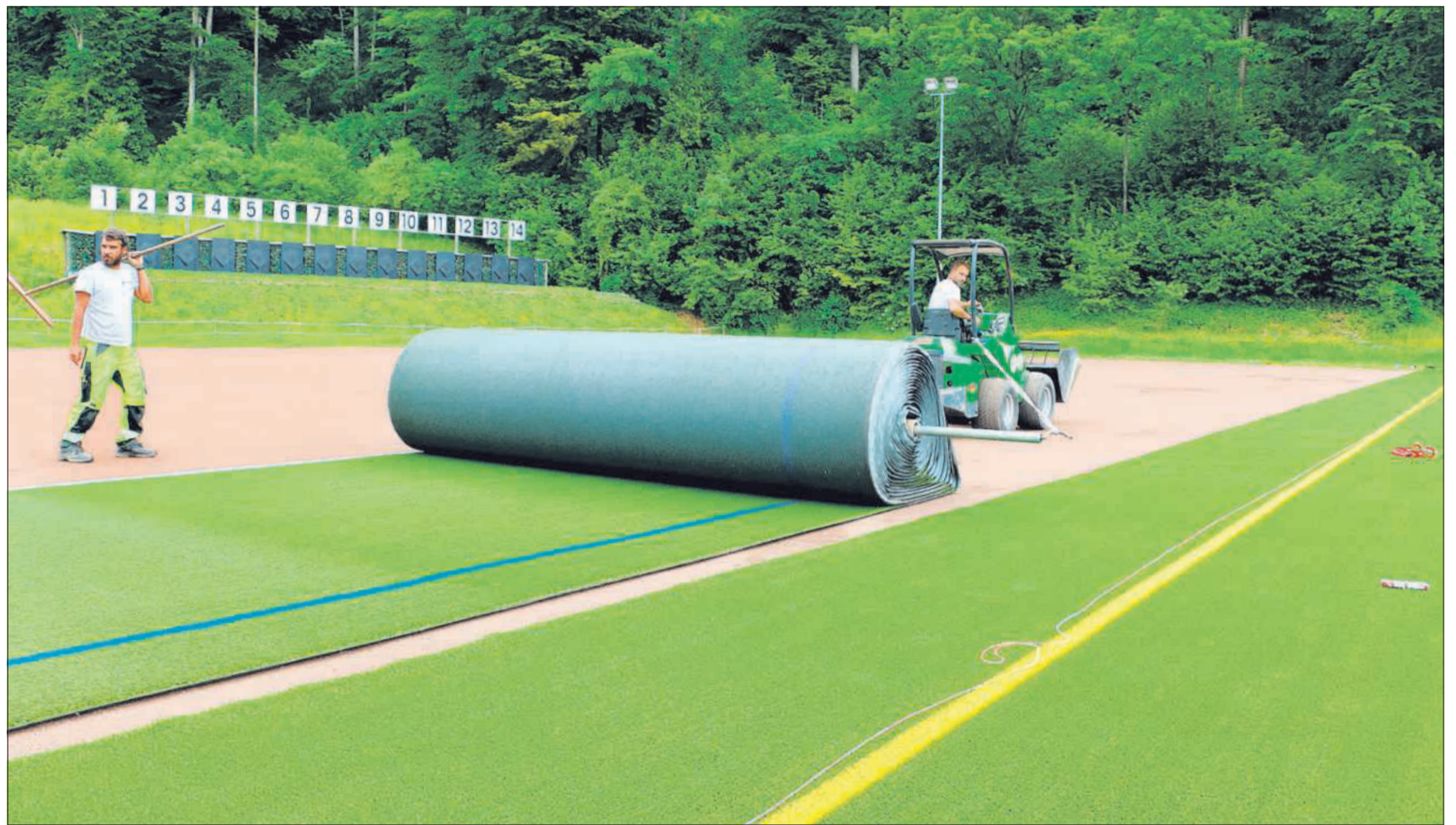
Diese Woche starteten die Sanierungsarbeiten auf der Wolhuser Blindei. Gestern wurde bereits der Kunstrasen verlegt. [Bild Shayeste Afzali]
